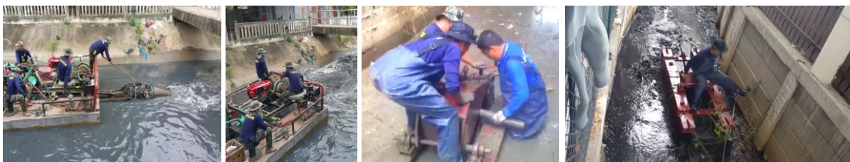
เครื่องเป่าดันตะกอนดินเลน และเครื่องมือตัดแปลง (คล้ายบั้งก็) ภายในคลองที่แคบ
